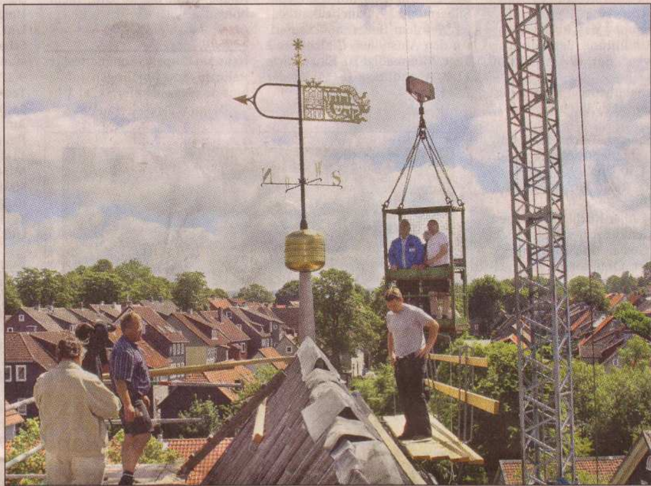
Seit gestern krönt die neue Wetterfahne den Ostgiebel der Marktkirche Zum Heiligen Geist. Enthüllt haben sie Dachdeckermeister Heinz Schimke (im Krankorb l.) und Dorothee Austen. Foto: Ebeling
