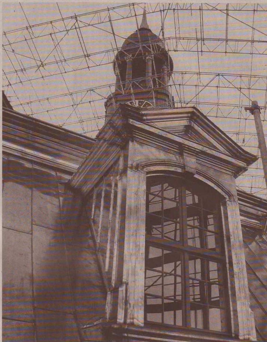
Bei der Neueindeckung der kompletten Dach-, Gauben- und Gesimsfläche des „Hamburger Michel“ werden zirka 44 t „Tecu-Classic“-Kupferblech verarbeitet. Die Blechdicke beträgt 0,7 mm bei einem Scharraster von 520 mm und einer Scharlänge von bis zu 2,0 m. Foto: Hermann Bade
