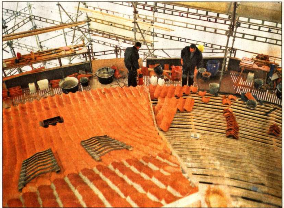
Imposante Meisterleistung: Sieben Wochen lang arbeiteten zwei bis drei Fachleute der Bevenser Firma Bade Dächer an der Restaurierung des Frederikshavner Wahrzeichens mit. Fotos: Privat
