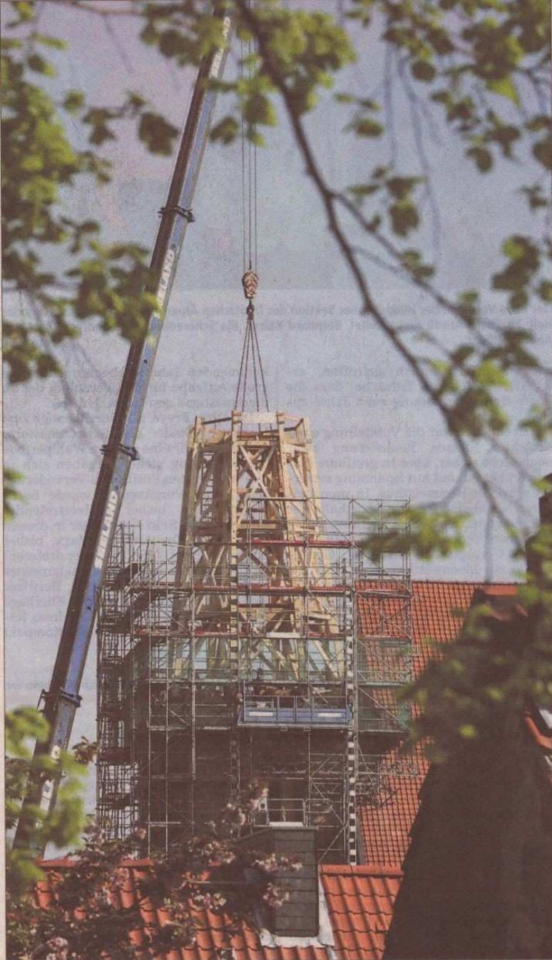
Eine ganz neue Silhouette im Stadtbild: Um zehn Uhr hebt der Kran den Turm auf seine Verankerung, eine Stunde später ist das Bauwerk befestigt. Fotos: Hartmann
